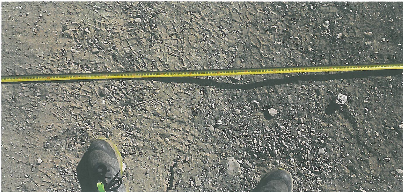
Foto 3 - Immagine realizzata durante il rilevamento geologico/ geomorfologico di dettaglio che mette in risalto le crepe secondarie presenti sulla carreggiata al di sopra del coronamento della frana ivi presente
