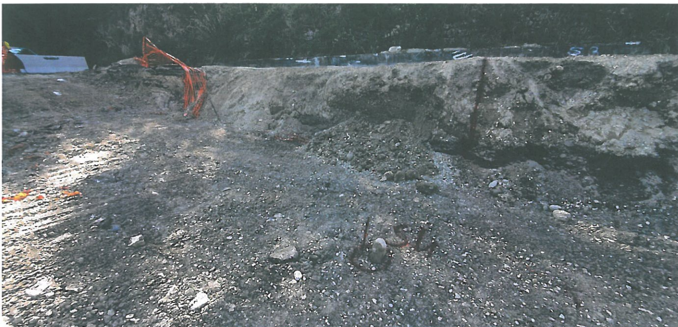
Foto 4 - Immagine realizzata durante il rilevamento geologico/ geomorfologico di dettaglio che mette in risalto la scarpata principale, il coronamento ed il fianco destro della frana (da notare che è stato modificato per realizzare la rampa per poter realizzare il sondaggio geognostico S4, carreggiata relitta direzione Cautano)
