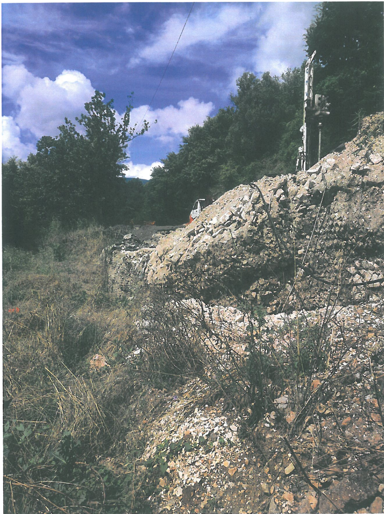
Foto 10 – Immagine realizzata durante il rilevamento geologico/ geomorfologico di dettaglio che mette in risalto la scarpata secondaria della frana nella zona di Testa con il coinvolgimento nell'areale del collasso delle opere di sostegno a gabbionate precedentemente realizzate .
